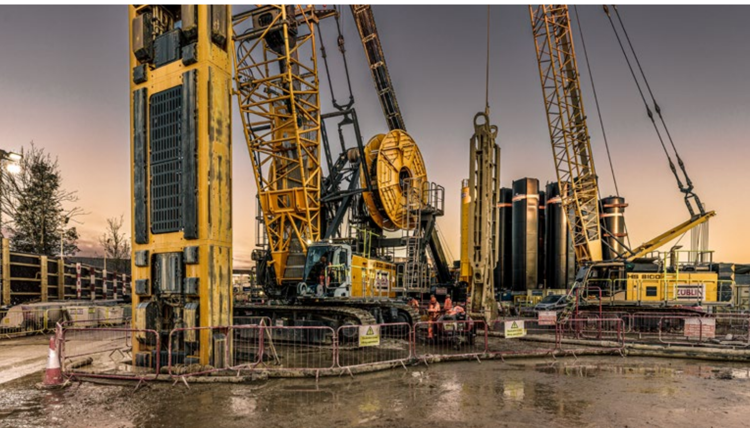
HS 8130 с фрезой и HS 8100 с плоским грейфером работают по технологии «стена в грунте» на площадке в Лондоне
