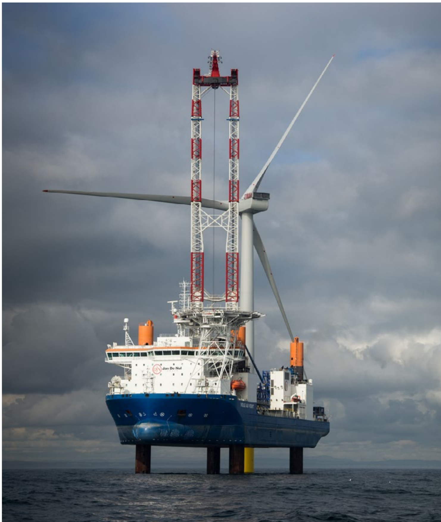
Этот кран CAL 45000, работающий на борту судна «Vole au Vent», может поднять до 1200 тонн
