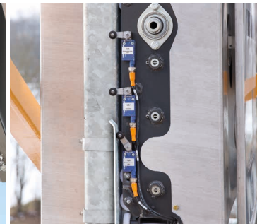
Der redundante Aufbau der Endschalter garantiert höchste Sicherheit
